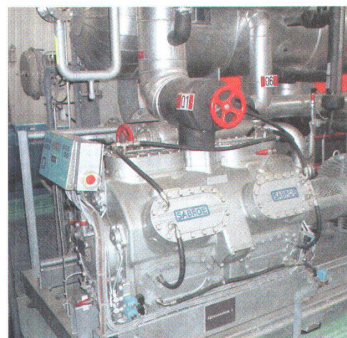
28 Kältezentrale Uni Irchel, Zürich
