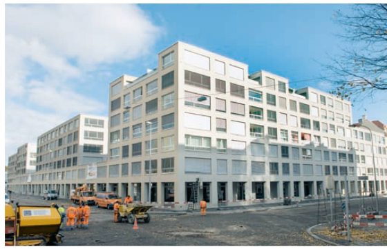
<12_Sabag-Areal: Die Fortsetzung des Stadtmusters des Roten Biel heute: ein städtischer Blockrand mit grossem Innenhof. Foto: Peter Samuel Jaggi
