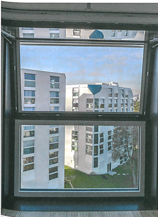
Das raumhohe Klappfensterelement macht Brüstungs- und Sturzdetails überflüssig und integriert Sonnenschutz und dezentrale Luftzufuhr.
