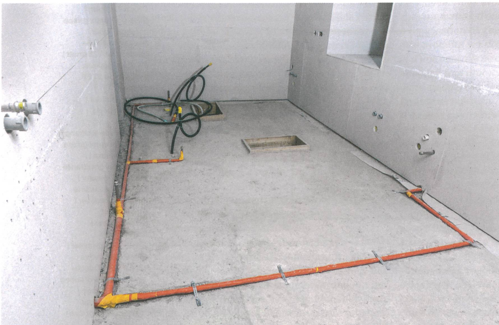
Die Gasleitung im Küchenrohbau. | Conduite de gaz dans le gros œuvre de la cuisine.
