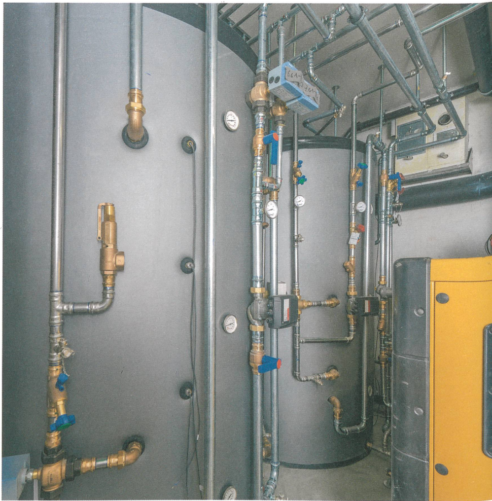
Solarspeicher und Warmwasserverteilung mit den Systemen «Optipress-Aquaplus» und «Optipress-Therm» von Nussbaum. | Accumulateurs solaires et distribution d'eau chaude intégrant les systèmes Optipress-Aquaplus et Optipress-Therm de Nussbaum.
