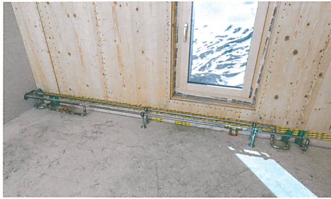
Leitungen für die Solaranlage. | Conduites destinées à l'installation solaire.
