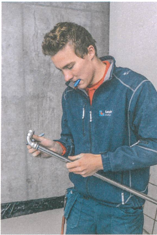
Der Installateur Dominic van Deuren markiert die Einstecktiefe für die Pressverbindung. | L'installateur Dominic van Deuren reporte la profondeur d'emboîtement pour le raccord à sertir.
