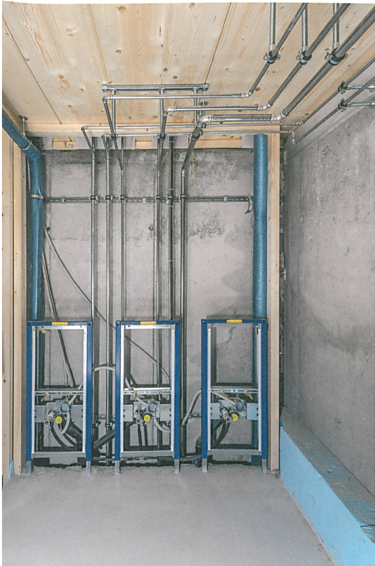
Steigzonen und Verteilleitung aus Edelstahl mit Pressfittings. | Des tuyaux en acier inoxydable à sertir composent les colonnes montantes et les conduites de distribution.
