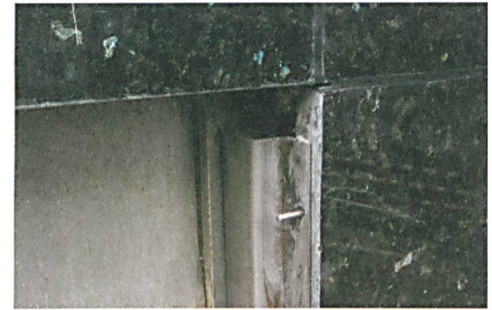
Die Fassade vor der Sanierung: Seitliche Metallstifte halten die Steinplatten.
