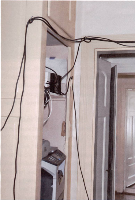
Pragmatische Kabelführung in der Altbauwohnung.
