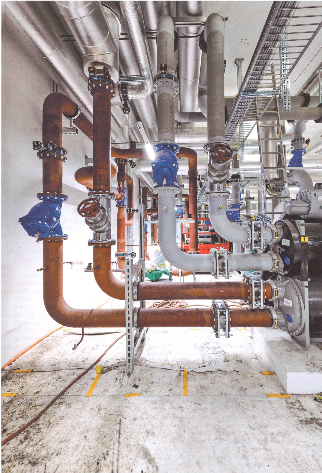
In der Energiezentrale unter dem Areal Pont-Rouge in Genf. | Dans la centrale énergétique en dessous du site de Pont-Rouge à Genève.
