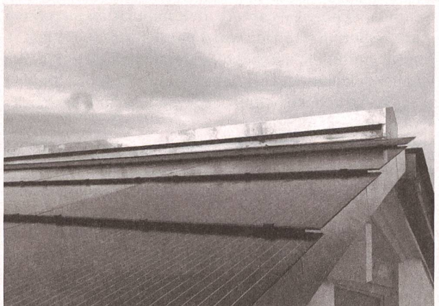
Dünn trotz neuer Dämmung und Hybridkollektoren (PV und Wärme): Umbau Kirche Ebmatingen von Daniel Studer.
