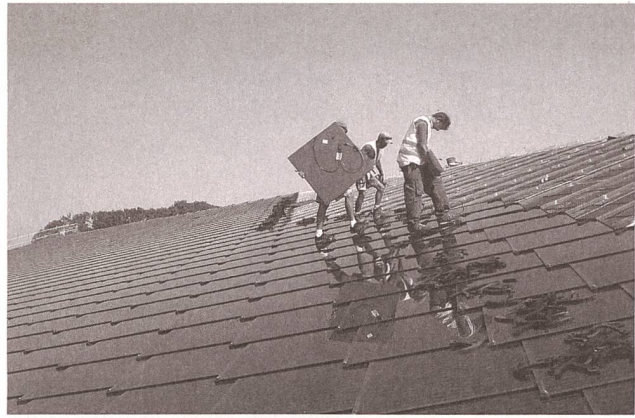
Eher Platten als Schindeln: Gibt es einen Massstabsvergleich, erscheinen Solarschindeln oft surreal gross. Foto: Sunstyle
