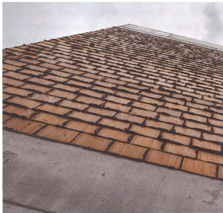
Besonders auffällig ist der herausgequetschte Mörtel.
