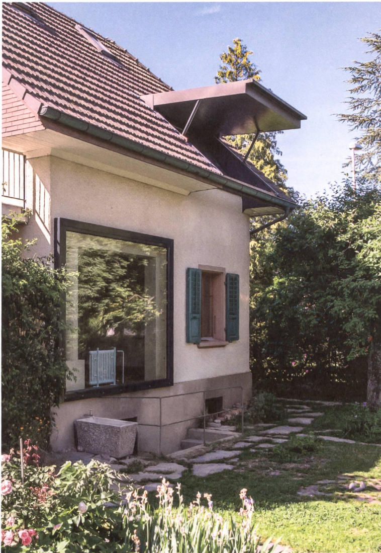
Kluger Parasit: Ein Holzbau ersetzt den Anbau; er schlängelt sich durch das Derendinger Einfamilienhaus und durchstösst die Fassade und das Dach. Foto: Paola Caputo
