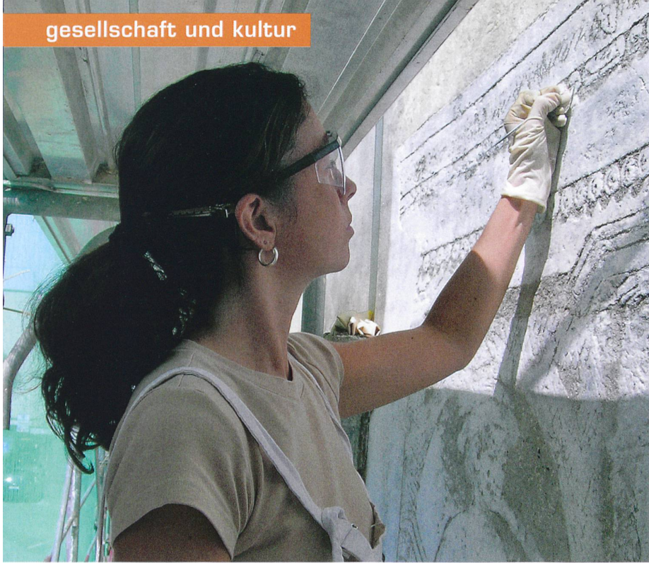
Mit antiker Technik zu neuem Glanz: Eine Restauratorin retuschiert ein Sgraffito in Roveredo. Bild: Albert Jornet
