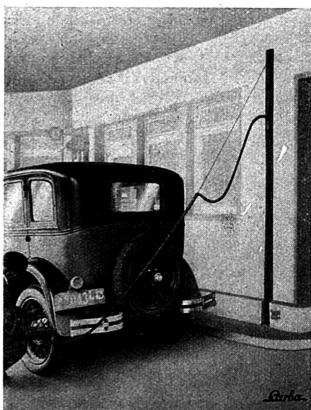
Druckluftwandstation im Innern einer Garage.
