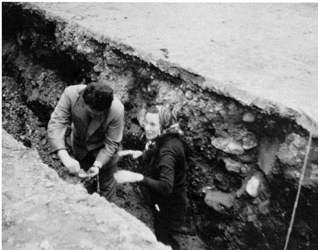
Im Kanalisationsgraben «Schmäuslemarkt» am 15. März 1978 Bauunternehmer A. Koch und Frl. Dr. J. Grüninger
