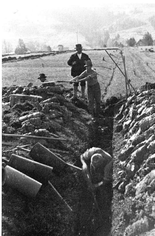
Legen der Entwässerungsröhren
