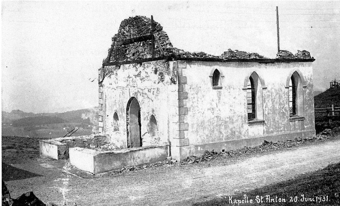
Die Kapelle ist am 20. Juni 1931 durch einen Blitzschlag zerstört worden.
