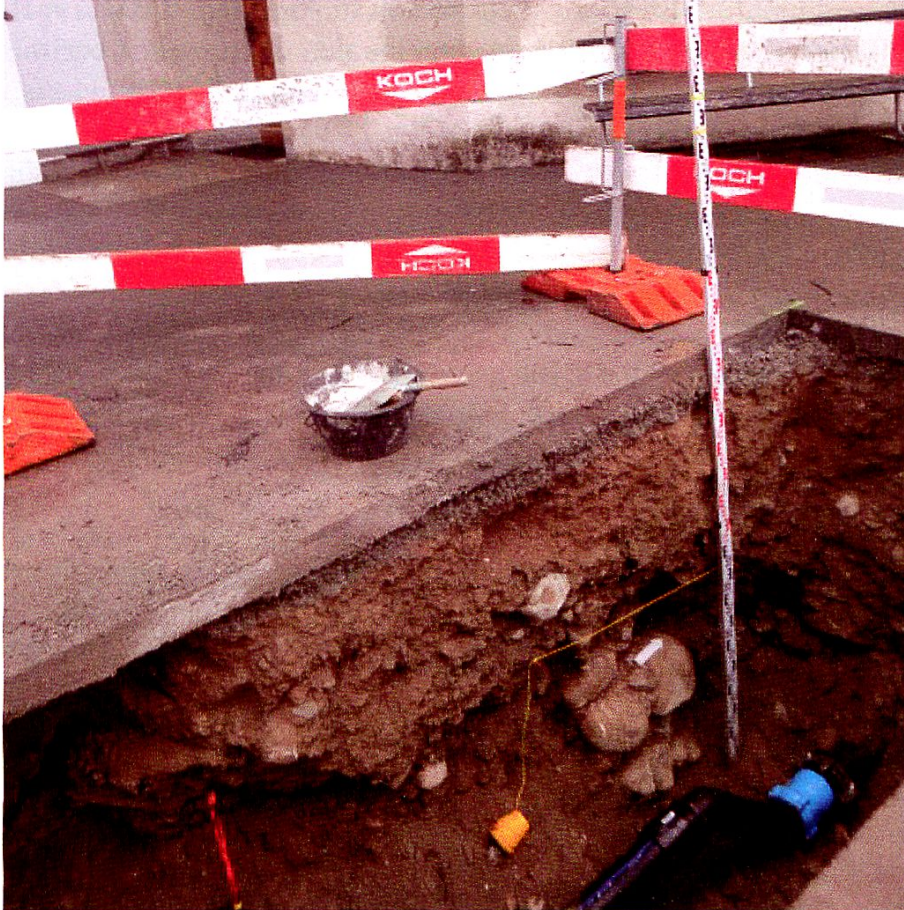
Leitungsgraben nahe des Chors der Pfarrkirche St.Mauritius. Angerissene Mauer.
