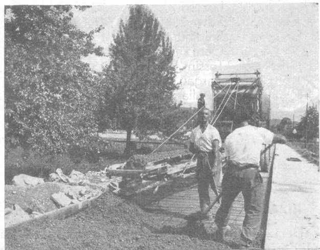
Abbildung Nr. 2. Betonmischmaschine, Selbstfahrer, mit Schwenkarm und Förderband; Verteilung der Mischung des Unterbetons über die Eiseneinlagen. Rechts eine Fahrbahnhälfte fertig betoniert.
