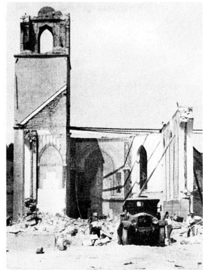
Abb. 128 Herisau. Gossauerstrasse. Kath. Kirche St. Peter und Paul, erb. 1877–1879. Abbruch Juni–Juli 1936. Photo P. Holenstein, aus der Festschrift zur Einweihung des Neubaus, 1937.
