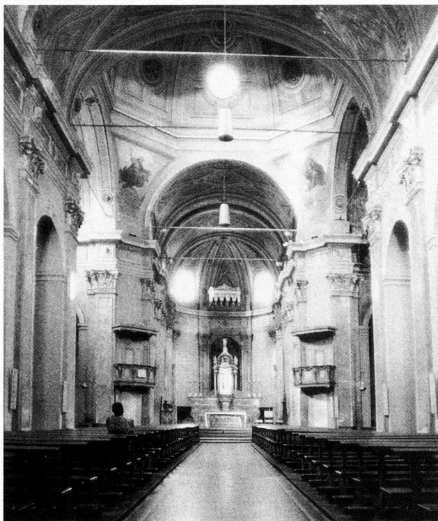
Ill. 39 Locarno. Navata della collegiata di S. Antonio Abate, ricostruita nel 1870-73, dopo il crollo della volta del 1863.
