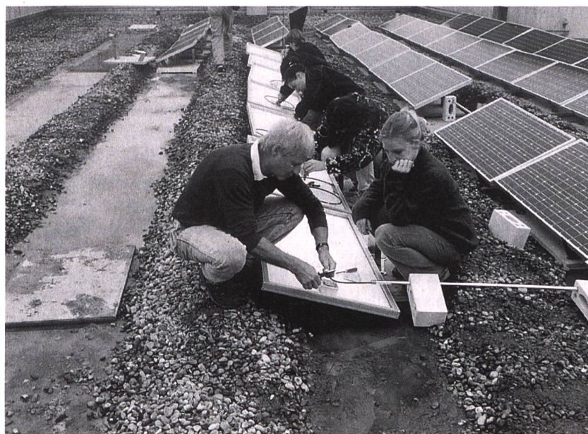
Solkraftwerk auf dem Dach der Kantonsschule Oerlikon
