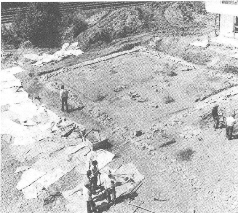
Abb. 9 Kaiseraugst, Auf der Wacht II, Parz. 231. Lose I-VIW. Überblick auf die Westhälfte der Insula bei Beginn der Ausgrabung. Aufsicht vom Kran von Süden.
