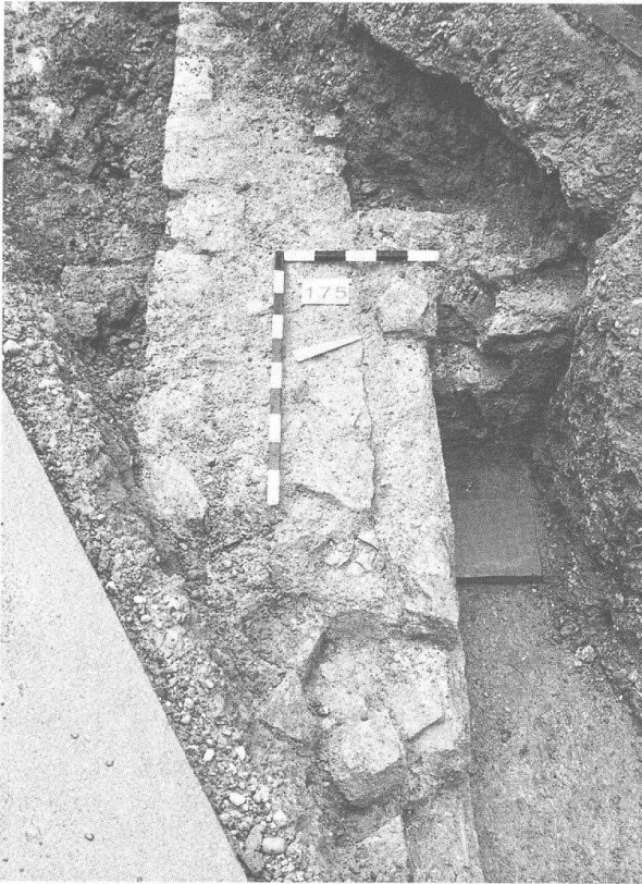
Abb. 18 Kaiseraugst – AEW-Fernkabelkanal/Bahnhofstrasse West (03). Hypokaustierter Raum der westlichen Bebauung der «Castrumstrasse». Aufsicht von SE.
