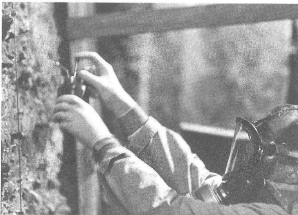
Abb. 3 Lackprofil-Abnahme beim Augster Theater 1988: Beim Sprühen wird darauf geachtet, dass ein möglichst gutes Eindringen der Mowilith-Lösung rund um die einzelnen hervorstehenden Steine erfolgt.
