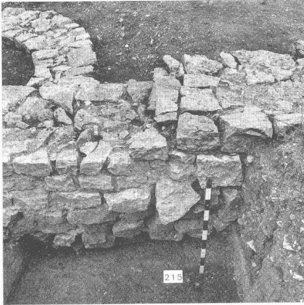
Abb. 16 Augst BL, Osttor. Grabung 1991.52. Baufuge in der Umfassungsmauer 7, östlich von Entlastungsbogen 18 (vgl. Abb. 15,2). Die Unterkante von Fundament und Vorfundament ist abgetrept.
