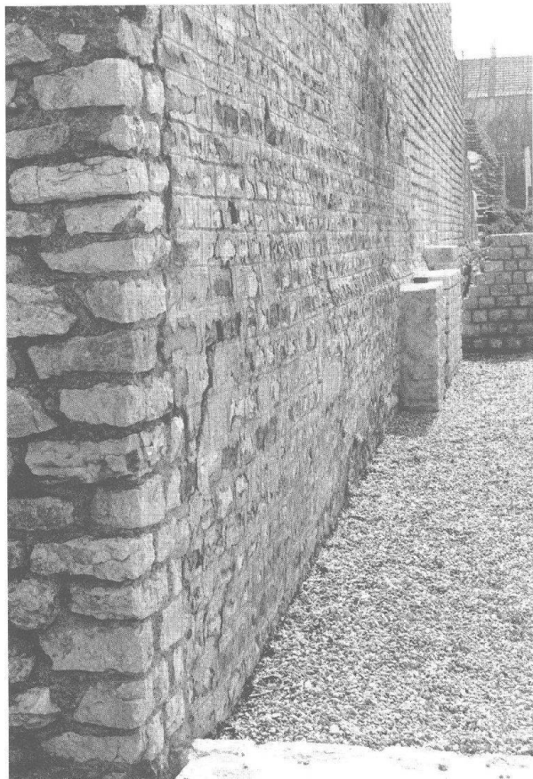
Abb. 2 Augst BL, Theater. Ausbauchung an der nordwestlichen Abschlussmauer (Westseite) als Folge langjähriger Verwitterung.
