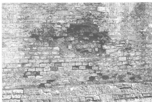
Abb. 5 Augst BL, Theater. Die Schäden an der Aussenseite der südwestlichen Abschlussmauer lassen sich auf die Spannungen zwischen römischem Kalkmörtel und modernem Zement zurückführen.
