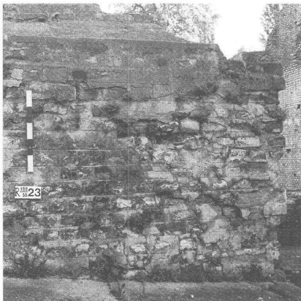
Abb. 25 Augst, Theatersanierung (Grabung 1992.55), Drittes Theater. Mit Portlandzement «restaurierte» Mauerpartie (nördliches Gewände des Fensters in Mauer 1; vgl. Abb. 27 und 31).
