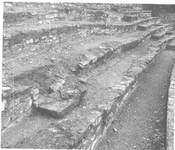
Abb. 3 Augst, Theatersanierung (Grabung 1992.55). Zerfallerscheinungen durch Auflösung des Mörtels und durch Abrutschungen (Sitzstufen-Fundamente in der mittleren Cavea des Dritten Theaters).
