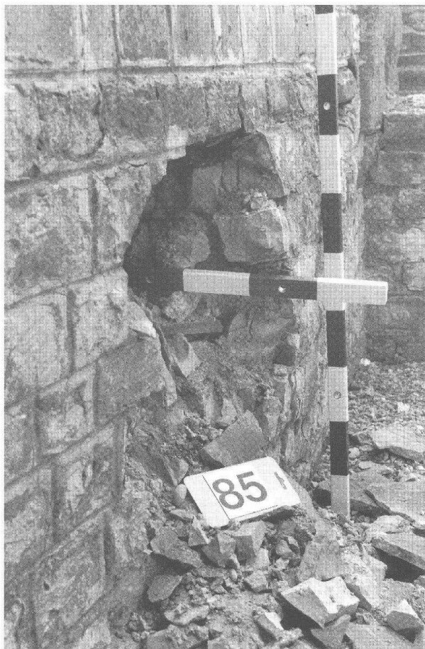
Abb. 26 Augst, Theatersanierung (Grabung 1992.55), Drittes Theater. Ausbruch als typisches Schadensbild am Augster Theater (Mauerschale der nördlichen Umfassungsmauer).
