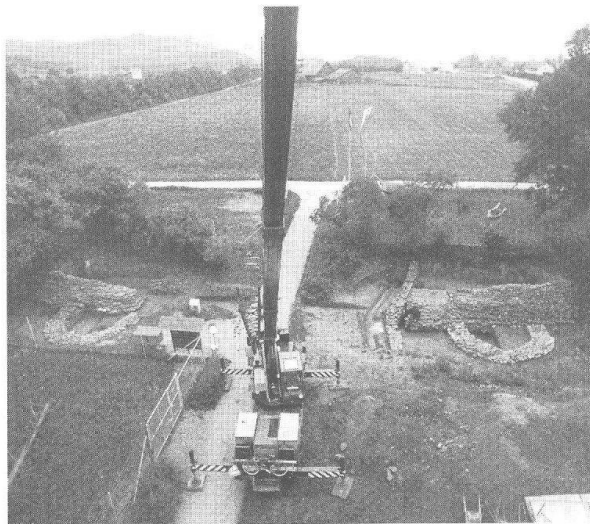
Abb. 36 Augst, Osttor (Grabung 1993.52). Das Osttor kurz vor Grabungsende. Blick gegen Südwesten ins Stadtinnere (Flur «Schwarzacker» mit den Insulae 49–53 am hintern rechten Bildrand). Unter den Bäumen am rechten und linken Bildrand sind die Reste der Stadtmauer verborgen.
