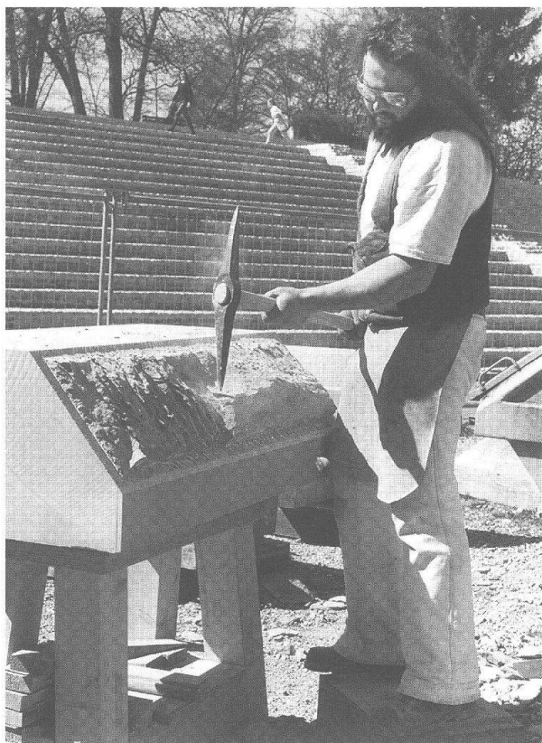
Abb. 33: Augst, Theatersanierung (Grabung 1997.55). Aufmauern der Stützpfiler nördlich der Umfassungsmauer (MR 57). Steinmetz Gregor Bucher an der Arbeit. Zurichten der Gurtstücke aus Sandstein mit dem Zweispitz, einem schon in der Antike bekannten Werkzeug.
