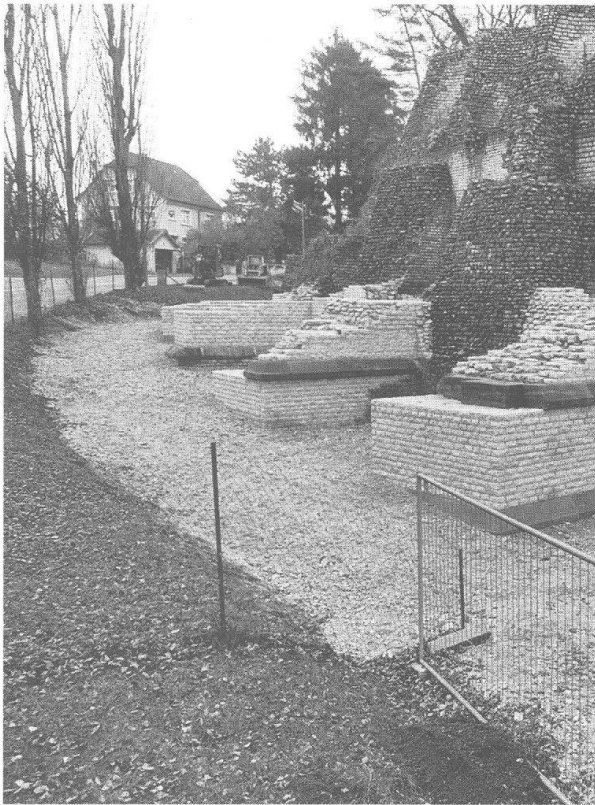
Abb. 36: Augst, Theatersanierung (Grabung 1997.55) Die Stützpfiler nördlich der Umfassungsmauer (MR 57) nach Beendigung der Arbeiten. Das Gelniveau liegt jetzt ca. 1,50 m höher. Die stark bröckeligen, zum Teil noch originalen Partien am Fuss der Umfassungsmauer sind jetzt dauerhaft geschützt.
