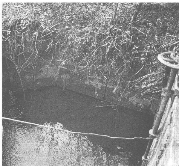
Abb. 18: Pratteln BL, Region 10 (Grabung 1997.74). Blick an die aus mächtigen Sandsteinquadern gefügte Wange des spätmittelalterlichen Mühlekanales im Bereich der Fassung. Zur Lage vgl. Abb. 15,3.
