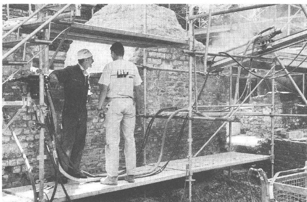
Abb. 41: Augst, Theatersanierung (Grabung 1998.55). Südaditus. Spezialisten der Firma Hoch & Tiefbau AG aus Sursee beim Einbau der Anker in die äussere Bühnenmauer 44.
