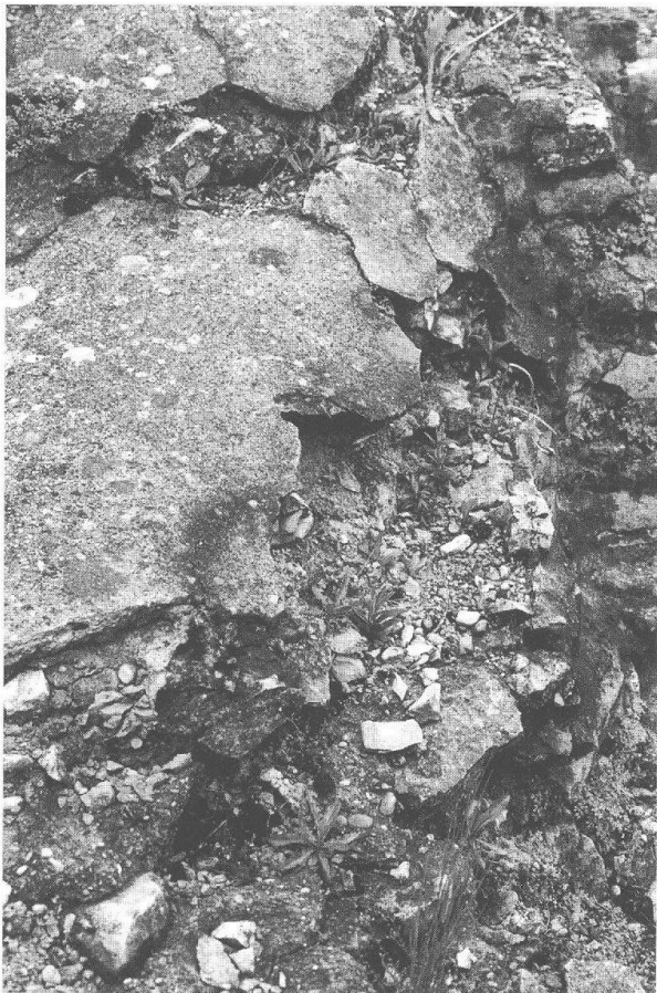
Abb. 36: Augst, Theatersanierung (Grabung 1994.55). Südaditus. Starke Frostschäden an der äusseren Bühnenmauer 44. Detail der Mauerkrone mit aufgebrochener und abgelöster Zementabdeckung von ca. 1907.
