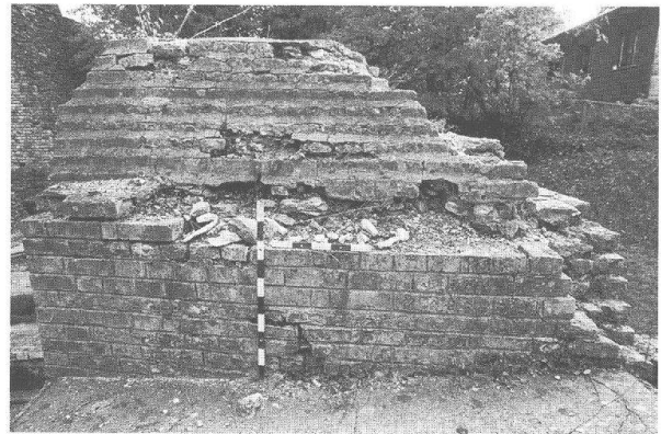
Abb. 35: Augst, Theatersanierung (Grabung 1997.55). Südaditus. Starke Frostschäden am südlichen Fenstergewände in der äusseren Bühnenmauer (MR 44). Die um 1907 als Witterungsschutz angebrachten Zementplomben haben sich vom originalen Mauerkern abgelöst.
