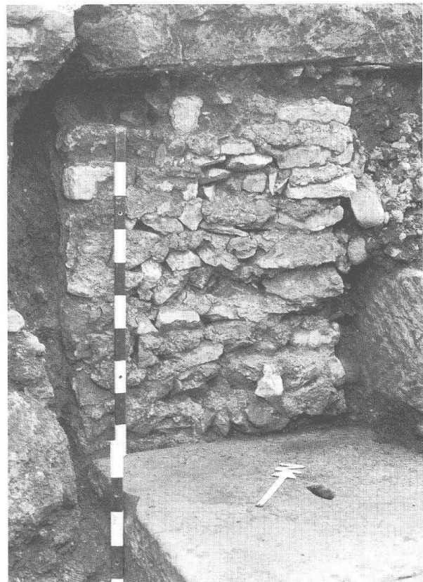
► Abb. 8: Augst, Theatersanierung (Grabung 1998.55). Ostcarcer des Amphitheaters. Blick von Süden auf die Sandsteinschwelle der südlichen Carcerpforte mit den schwach erkennbaren Quaderarbeiten. Im Hintergrund Reste des an die ehemaligen Gewändequader anstossenden Kalksteinmauerwerks und unmittelbar darüber die Sandsteinplatten der Altar- oder Statuennische des jüngeren szenischen Theaters.
