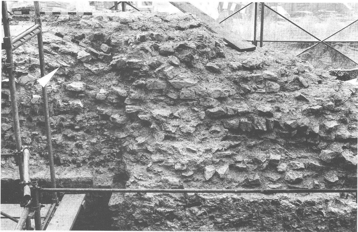
Abb. 5: Augst, Theatersanierung (Grabung 1998.55). Südaditus, westliche Bühnenmauer (MR 44). Ostseite von Mauer 44 mit der abgestuft verlaufenden Abmauerung für das Widerlager der Aditusüberwölbung. Der Pfeil markiert den Ausschnitt von Abbildung 6.
