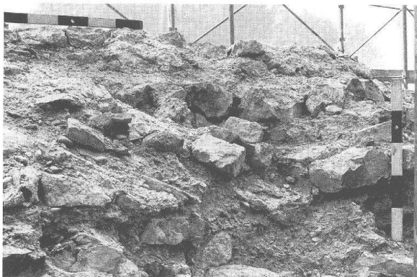
Abb. 6: Augst, Theatersanierung (Grabung 1998.55). Südaditus, westliche Bühnenmauer (MR 44). Ostseite von Mauer 44; Bereich der kammerartigen Erweiterung mit zur Orchestra hin geneigter Bettung für die Aditusüberwölbung und Resten der Kämpferlinie aus Buntsandstein.
