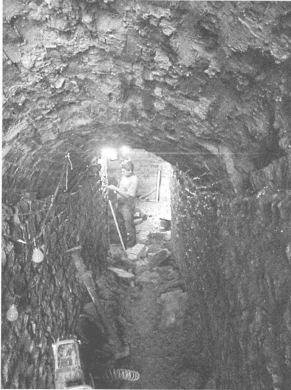
Abb. 43: Augst, Violenried, ehemaliges E. Frey-Areal (Grabung 2000.60, Konservierung 2000.925). Ersatz von wenigen Tuff- und Kalksteinen im Tunnelbereich.
