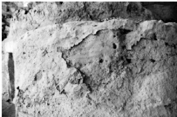
Abb. 36: Augst, Gebäude zwischen der Insula 9 und dem Theater. Konservierung des Backofens in der «Taberne» (2001.907). Das Konservierungsmittel Calaton hat sich gelöst; die Wespen verursachten Löcher in der römischen Lehmkonstruktion.
