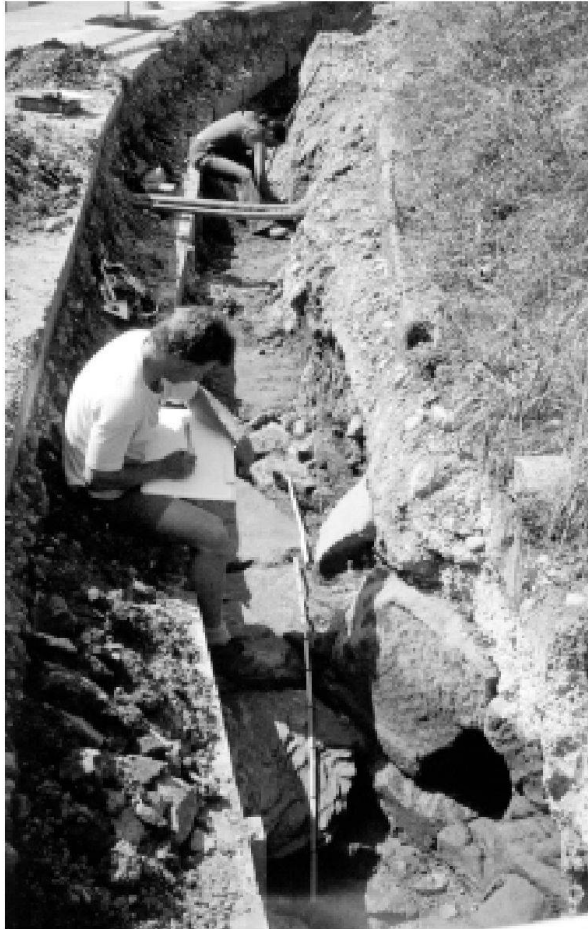
Abb. 29: Augst, Sanierung der Wasserleitung im untersten Teil der Giebenacherstrasse (Grabung 2001.61), zwischen Römerhaus und Hauptstrasse. Die Unvorhersehbarkeit eines Leitungsbruchs (80-jährige gusseiserne Wasserleitung) und mehrfach verändertes Vorgehen der Bauherrschaft führten zu einer Hektik auf der Baustelle und zwangen zu verzettelten Dokumentationseinsätzen und entsprechend unbefriedigenden Arbeitsbedingungen vor Ort. Das Bild veranschaulicht den willkürlichen Ausschnitt aus einer römischen Hofsituation mit einem Brunnen(?) aus grossen Buntsandsteinplatten und deren improvisierte zeichnerische Dokumentation (im Vordergrund Stefan Bieri).
