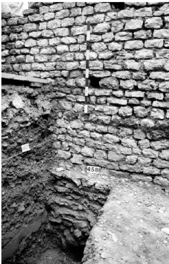
Abb. 18: Augst BL, Kunz-Suter (Grabung 2001.51). Mauer MR 6, Aufgehendes und Fundament an der Innenseite = Ostseite. Von Nordosten.
