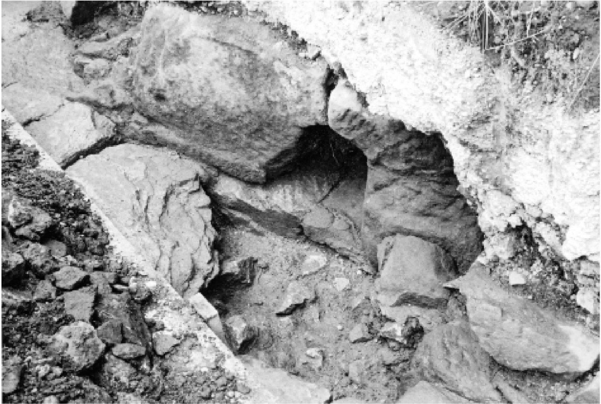
Abb. 38: Augst BL, Wasserleitung Giebenacherstrasse (Grabung 2001.61). Ansicht an die in die Nordwand des Innenhofs eingelassene Öffnung.
