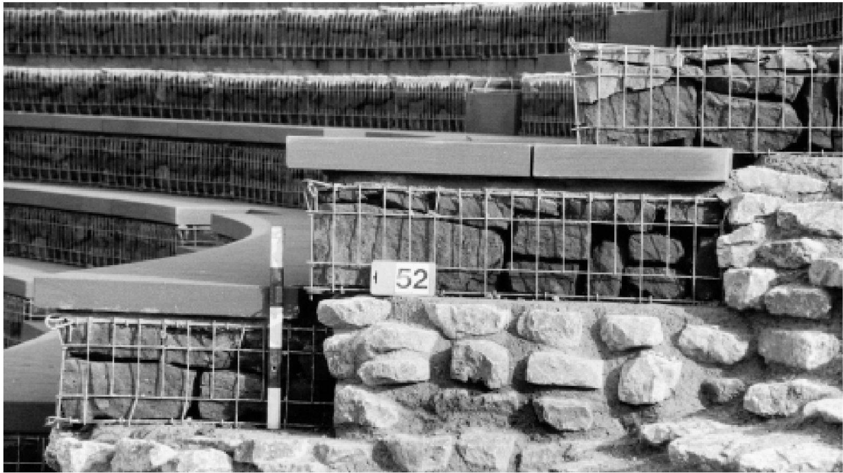
Abb. 15: Augst, Theatersanierung (Grabung 2001.55). Moderne Sitzstufenrekonstruktion. Fertiggestellte Stufen mit Gitterkörben, Sandsteinfüllung und Abdeckplatten aus Buntsandstein. Sichtbare Seitenflächen am Westende des Sitzstufeneinbaus.
