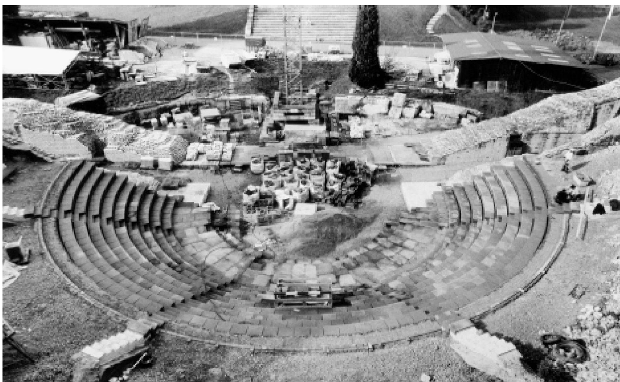
Abb. 27: Augst, Theatersanierung (Grabung 2001.55). Moderne Sitzstufenrekonstruktion. Blick vom zweiten Rang auf die fertiggestellte untere Hälfte der cavea. Deutlich erkennbar sind der Orchestraengang und die Treppenläufe mit ihren auf der Auffüllung aufliegenden Betonfundamenten. Der Blick von oben lässt die Gitterkörbe vollständig verschwinden, so dass nur noch das geometrische Muster der Sandstein-Abdeckplatten sichtbar ist.
