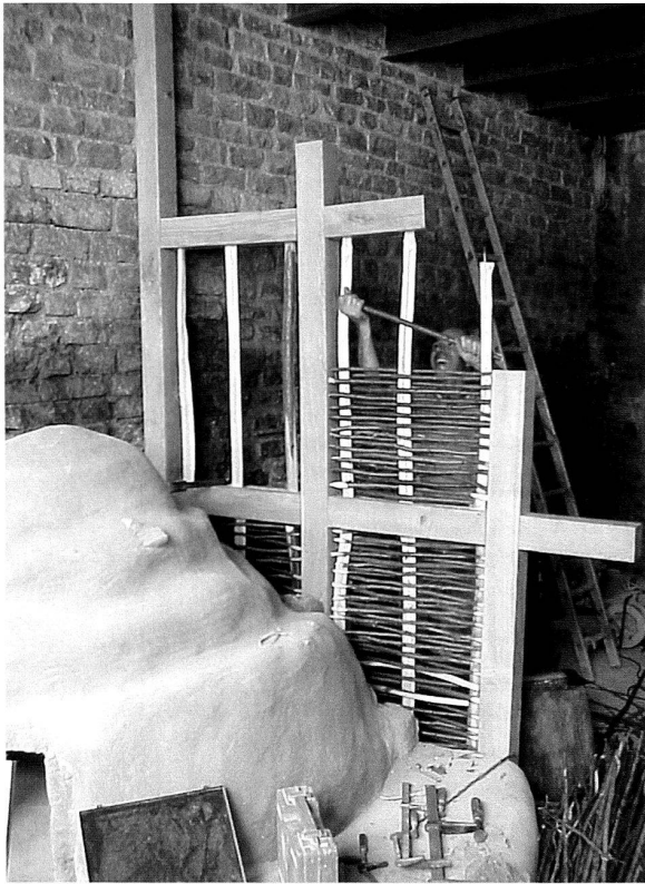
Abb. 42: Augst, Gebäude zwischen der Insula 9 und dem Theater. Konservierung «Bäckerei» und «Wachposten» (2002.907). Rolf Fischler beim Flechten der Lehmfachwerkwand.
