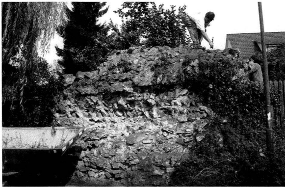
Abb. 47: Kaiseraugst, Kastellmauer am Heidemurweg im Zustand vor der Neukonservierung (2002.915): hohl aufgebrochen, ohne Mauerschalen und mit schädigendem Pflanzenbewuchs auf der Mauerkrone.
