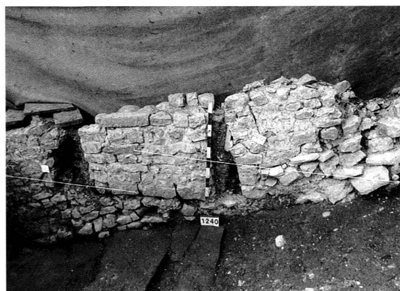
Abb. 30: Augst BL, Degen-Messerli (Grabung 2001–2002.64). In einer Umbauphase zugemauerte Tür in der Mauer zwischen den Räumen [7] und [8] (vgl. Abb. 29). Die Tür wies einen hölzernen Türrahmen auf, dessen Negativ als Lücke erhalten blieb. Die vielleicht einmal vorhandene steinerne Schwelle hat man vor dem Zumauern entfernt. Links unten angeschnitten die aus grossen Buntsandsteinen konstruierte Treppe in Raum [8]. Von Süden.
