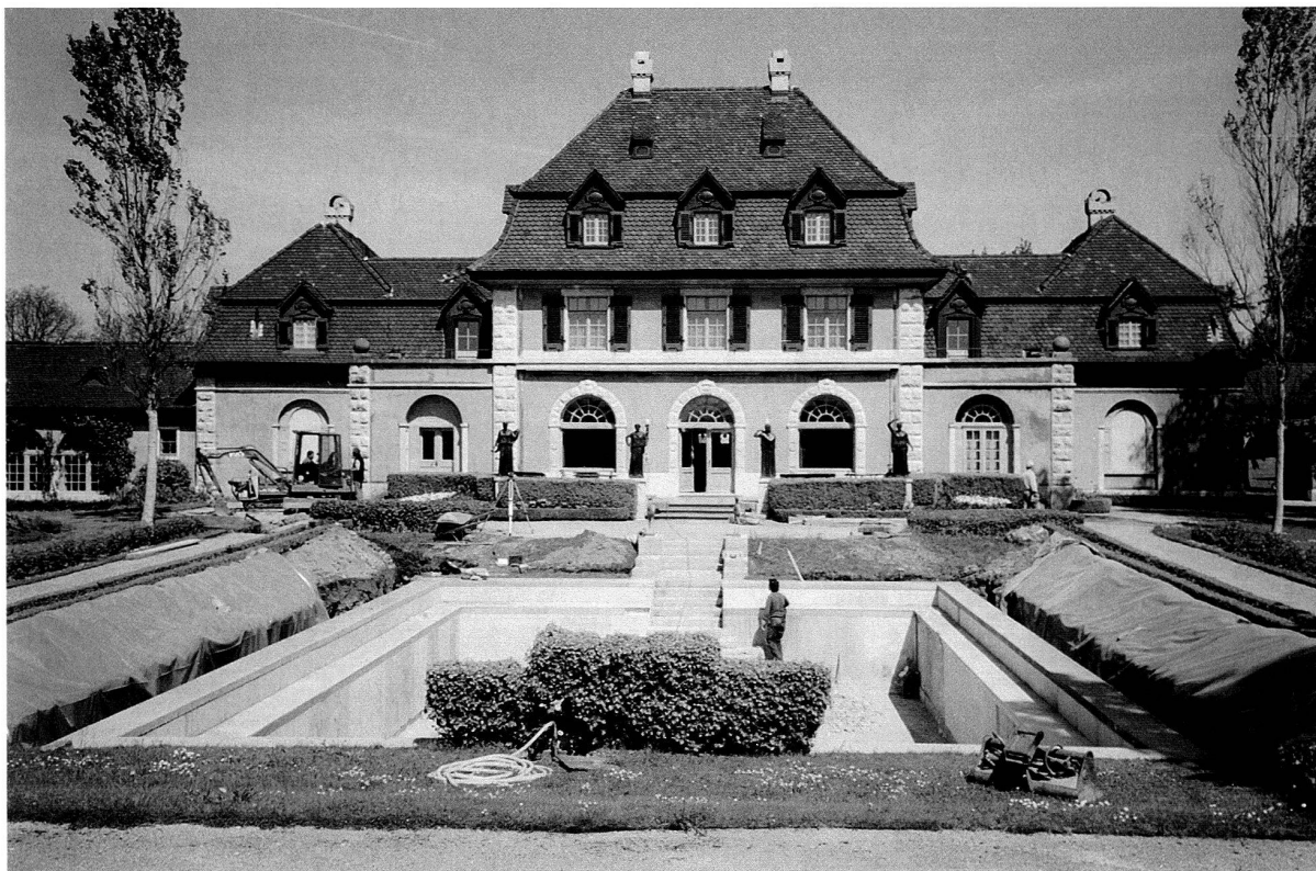
Abb. 3: Augst BL, Kastelen-Bassin (Grabung 2002.51). Blick von Westen zur Villa Clavel. Im Vordergrund das Schwimmbassin mit den bereits ausgehobenen Gräben.
