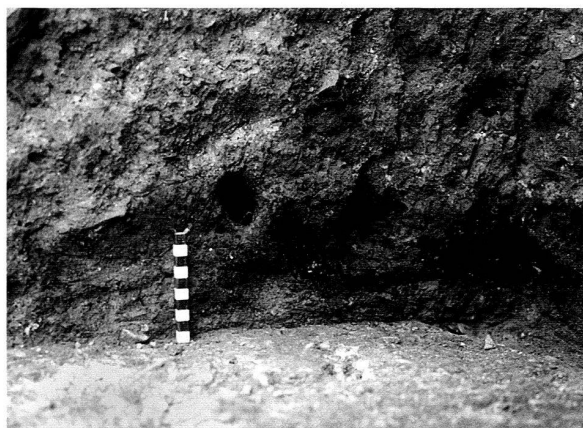
Abb. 21: Augst BL, Taberne (jetzt «Bäckerei und Wachposten») (Grabung 2002.63). Detail aus dem Fenster im Westprofil (Abb. 20). An der Basis des Profils der verkohlte Schwellbalken auf der westlichen Abschlussmauer des Gebäudes. Die Strassenseite wäre rechts (Neuntürmestrasse). Von Norden.
