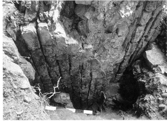
Abb. 3: Augst, Theatersanierung (Grabung 2002.55). Blendbogen der südlichen Eingangshalle. Ansicht an die im Befund untere Mauerschale des abgestürzten Mauerblocks mit Blendbogenrest und bogenförmig verlaufender Mörtelbraue. Zustand während der Freilegung.
