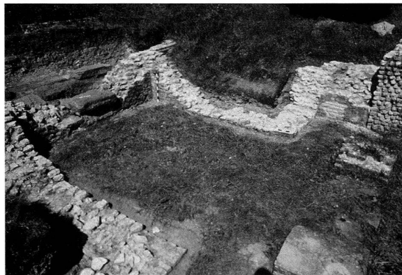
Abb. 42: Augst, Theatersanierung (Grabung 2002.55). Sanierungsarbeiten am Westcarcer des älteren Amphitheaters. Übersicht nach Entfernung der alten, stark beschädigten Zementrestaurierungen. Die antike Mauerkrone ist vollständig freigelegt, gereinigt und partiell injiziert. In einem nächsten Arbeitsschritt erfolgt das Aufbringen einer dampfdiffusionsfähigen Isolationsschicht zum Schutz vor eindringendem Meteorwasser. Nach der Ergänzung der abgebauten Mauerteile folgt als Verschleisschicht eine den antiken Mauerkern imitierende Abdeckung aus Kalksteinschroppen.
