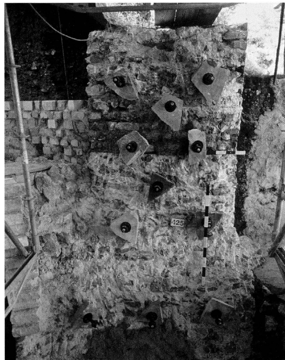
Abb. 37: Augst, Theatersanierung (Grabung 2002.55). Sanierungsarbeiten am Mittelvomitorium. An neuralgischen Stellen wird die Verbindung des neu vorgemauerten Kernmauerwerks mit dem originalen Kalksteinmauerwerk durch Glasfaseranker verstärkt. Arbeitsfoto vor dem Aufmauern der neuen Kernvornauerung.
