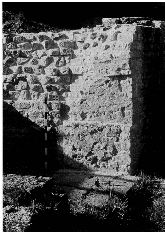
Abb. 43: Augst, Theatersanierung (Grabung 2002.55). Sanierungsarbeiten am Westcarcer des älteren Amphitheaters. Fertig gestellte Anschlüsse der Podiumsmauer an die Nordwestecke des Westcarcers. Wo einst Sandsteinquader als Gewände der Carcerpforten eingebaut waren, finden sich heute, als Folge des antiken und frühneuzeitlichen Steinraubs, nur noch die beim Ausbrechen der Quader entstandenen Raubtrichter. Im Falle des Westcarcers konnte Karl Stehlin in den 1920er Jahren noch die im Kernmauerwerk der Podiumsmauer erkennbaren Negativabdrücke der einst vorhandenen Steinblöcke dokumentieren. Auf der Basis dieser Dokumentation wurden 2002 diese Quadernegative zum besseren Verständnis der baulichen Situation wieder hergestellt.
