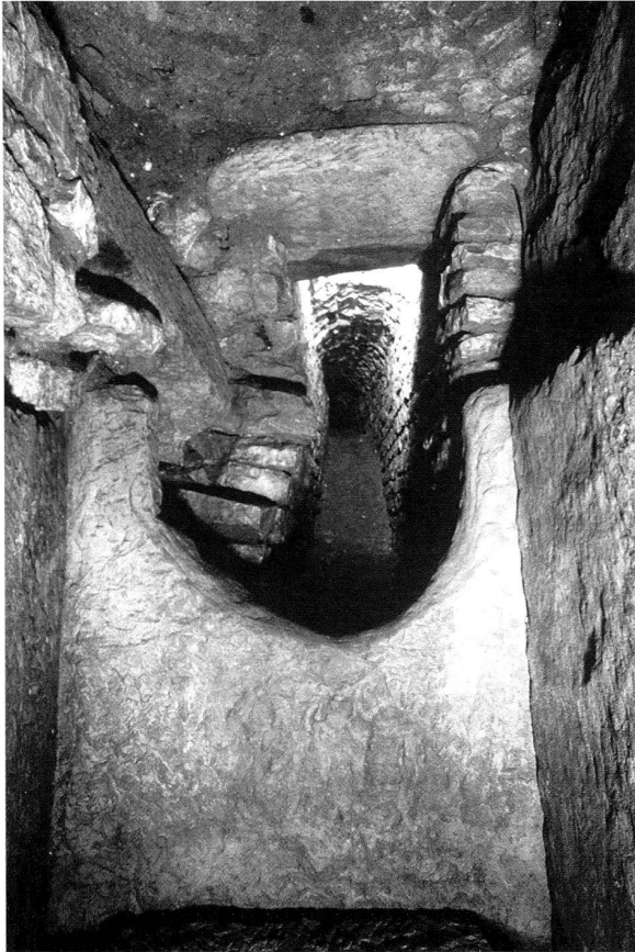
Abb. 24: Augst, Theatersanierung (Grabung 2002.55). Abwasserkanal, Verzweigung im Süden, südöstlicher Abschnitt mit Sandsteinkammer. Blick von Nordwesten, von der Sandsteinkammer aus in den südöstlichen Fortsetzungskanal. Im Zentrum die U-förmig ausgehauene Mündung; in der oberen Bildhälfte der Sandsteinarchitrav mit dem Entlastungsbogen aus Buntsandsteinkeilen (vgl. Abb. 27). Links der verstürzte Sandsteinarchitrav des von den Frauenthermen her kommenden, nordöstlichen Seitenkanals (vgl. Abb. 29).
