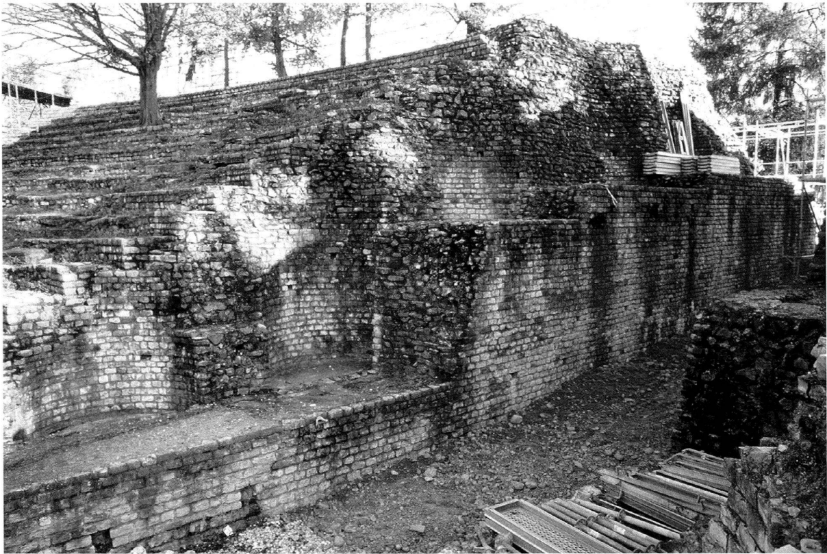
Abb. 35: Augst, Theatersanierung (Grabung 2002.55). Sanierungsarbeiten am Mittelvomitorium. Zustand des Mittelvomitoriums vor Beginn der Arbeiten 2002. Die so genannte Mittelstufe des älteren szenischen Theaters ist bereits verfüllt und nicht mehr sichtbar.
