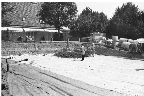
Abb. 39: Kaiseraugst AG, EFH Hockenjos, Äussere Reben (2003.05). Blick von Nordwesten auf die Trennfolie mit einer ersten Schüttung des Schaumglasschotters für die Isolationschicht. Im Osten steigt das Gelände an und unter der modernen Planierschicht liegen römische Schichten.
