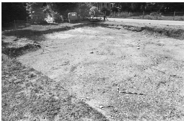
Abb. 38: Kaiseraugst AG, EFH Hockenjos, Äussere Reben (2003.05). Erste Massnahme zum Bau eines Einfamilienhauses «über den Ruinen». Abhumusierte Fläche von Osten (vgl. Abb. 39–41).
