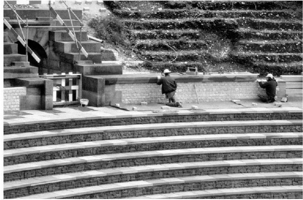
Abb. 24: Augst, Theatersanierung (Grabung 2003.55). Rekonstruktion der Sitzstufen im ersten Rang. Versetzen der Sandsteinabdeckung über der Gürtelmauer der ersten praecinctio.
