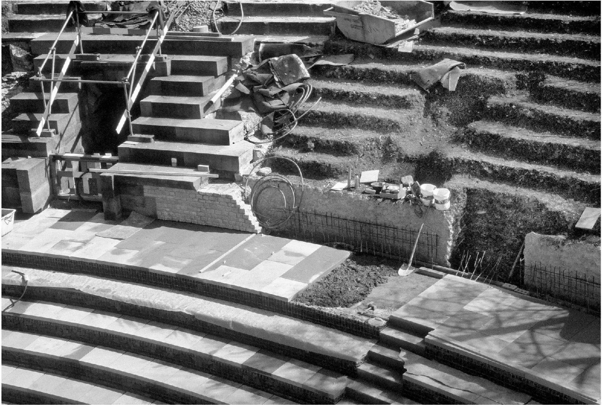
Abb. 21: Augst, Theatersanierung (Grabung 2003.55). Rekonstruktion der Sitzstufen im ersten Rang. Versetzen des Plattenbelags des Diazoma-Umgangs (Umgang der ersten praecinctio).
