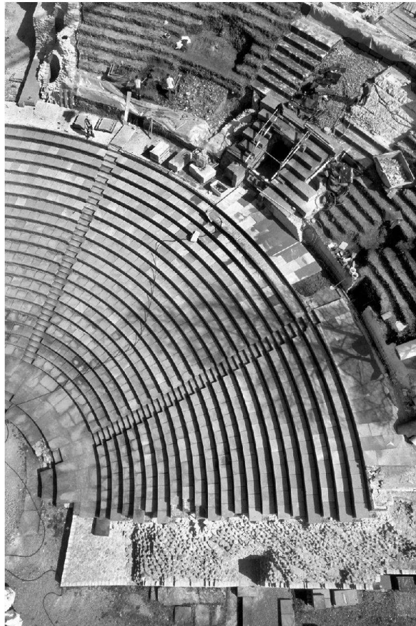
Abb. 20: Augst, Theatersanierung (Grabung 2003.55). Rekonstruktion des Sitzstufenbereichs. Aufsicht auf die Südhälfte während der Versetzarbeiten für die Platten des so genannten Diazoma-Umgangs (Umgang der ersten praecinctio).
