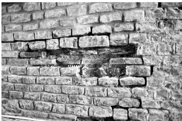
Abb. 35: Augst, Theatersanierung (Grabung 2003.55). Sanierung originaler Mauerschalen. Schwere Schäden an den Ziegelbändern einer antiken Reparatur an der südlichen Mauerschale des Südost-Vomitoriums.
