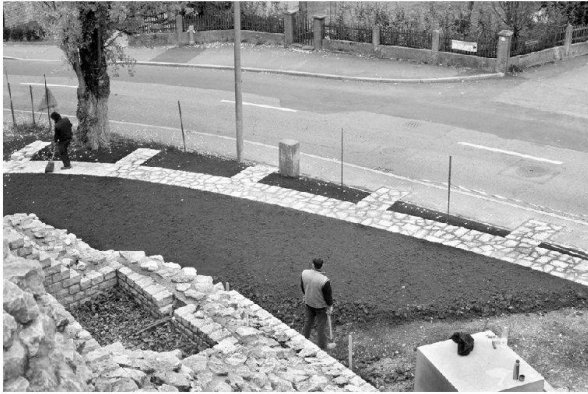
Abb. 38: Augst, Theatersanierung (Grabung 2003.55). Umgebungsgestaltung. Fertiggestellte Umgebung in Keil 2. Die bodenebene Kalksteinmarkierung der Umfassungsmauer des älteren szenischen Theaters ist in dieser Zone bereits ausgeführt; ebenso konnten die Geländearbeiten und das Einbringen des Schotterrasens für die Gehwege abgeschlossen werden. Blick vom Keil 2 nach Norden.
