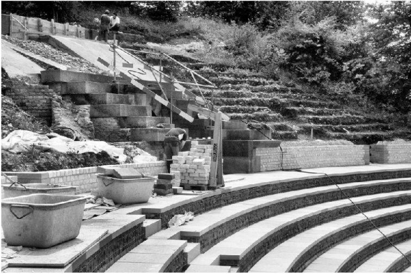
Abb. 23: Augst, Theatersanierung (Grabung 2003.55). Rekonstruktion der Sitzstufen im ersten Rang. Aufmauern der Gürtelmauer der ersten praecinctio.
