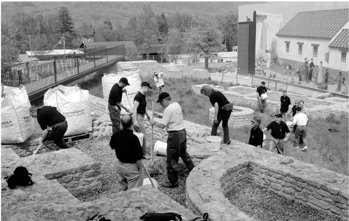
Abb. 53: Zwölf Mitglieder des Management des Preclinical Safety Departments leisten in Augusta Raurica Schwerarbeit am «Novartis Tag der Partnerschaft» (vgl. Abb. 55). Sie wechseln den grauen Schotter in den Hohlräumen der Kastelen-Hangstützmauer bei der Badeanlage mit beigem Material aus. Dank der ehrenamtlichen Aktion sind heute die Raumfunktionen über die Farbigkeit ihrer Schotterfüllung ablesbar: rot für beheizte Badebereiche, grau für nicht heizbare Räume und beige für konstruktive Mauerelemente.
