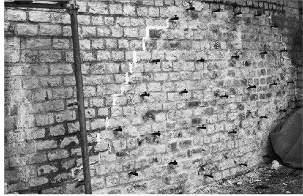
Abb. 44: Augst, Theatersanierung (Grabung 2004.055). Peripheriebereich Keil 4 (MR 58): Nach der Feinsanierung der Mauer- schale mit dem rot be- malten Fugenstrich und dem Abdichten möglicher Austrittsöffnungen wur- den die Packer zum Einbringen des Injektionsmörtels gesetzt. Der Raster zum Setzen der Packer wurde durch die Erhaltungsgrenzen der antiken Fugmörtel- partien bestimmt. Blick von Süden, im Hintergrund Pfeiler MR 195.
