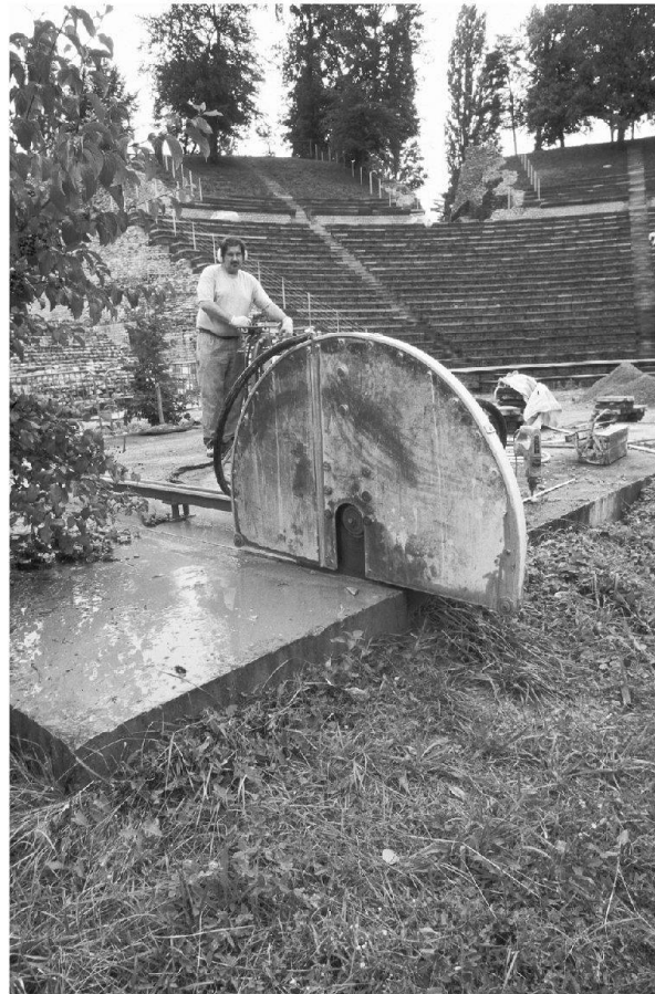
Abb. 48: Augst, Theatersanierung (Grabung 2004.055). Orchesterbereich: Durch die Firma Stark-Betonbohren, CH-4133 Pratteln, wird die Betonplatte des Kranfundaments mittels eines riesigen Fräsblattes zu Stücken von 1,5 Tonnen Gewicht zersägt.
