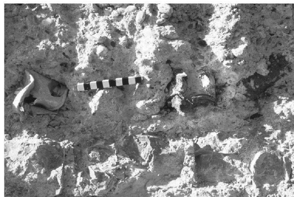
Abb. 35: Augst, Theatersanierung (Grabung 2004.055). Peripheriebereich Keil 3 (MR 58), Arbeitsstand vor Beginn der Aufmauerungsarbeiten: In dem aus den 1940er Jahren stammenden Mauerwerk wurden sogar leere Konservendosen vermauert.
