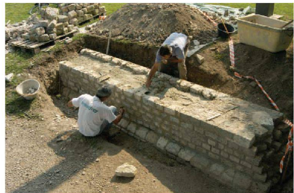
Abb. 59: Augst, Augusta Raurica. Konservierungsarbeiten an der Basilikamauer oberhalb der Curia (Abb. 58) durch Avelino Matos de Cruz (rechts) und Antonio Matos de Cruz.
