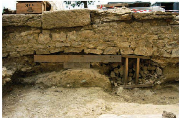
Abb. 62: Augst, Augusta Raurica, Insula 27. Eine der im Fundamentbereich ausgebrochenen und provisorisch gestützten römischen Mauern (MR 11) vor ihrer Reparatur und Konservierung (vgl. Abb. 63).
