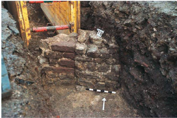
Abb. 10: Augst BL, Schufenholzweg (Grabung 2005.053). Insula 28 (oder 34), innere Trennmauer mit (rechts) einer zugemauerten Türe, deren Gewände aus Buntsandsteinen links zu sehen ist. Von Süden.
