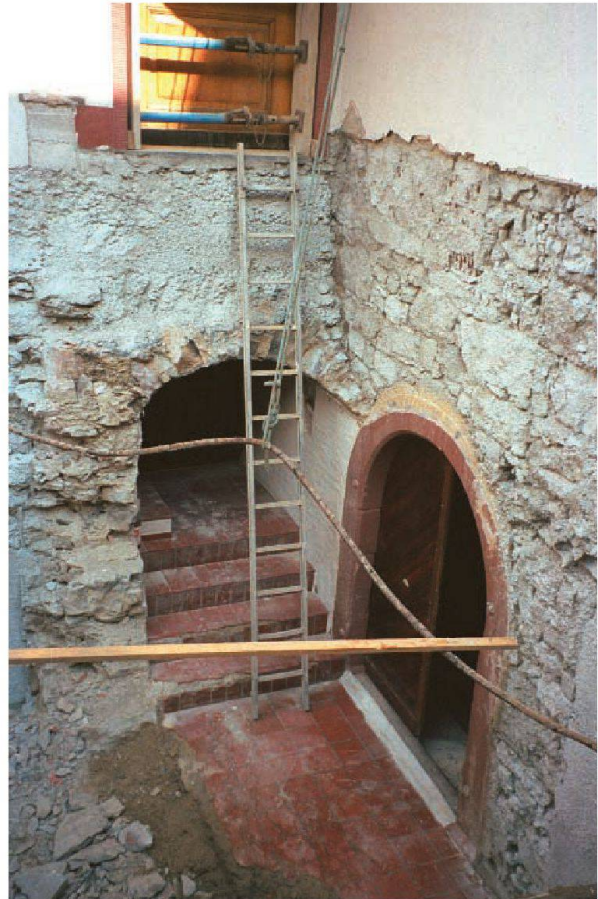
Abb. 23: Augst BL, Gemeindehaus (Grabung 2005.056). Nur während des Umbaus zu sehen: rechts das Tor zum «Gewölbekeller» unter dem Gemeindehaus, hinten der Rest des Zugangstunnels vom Anbau her. Von Südosten.
