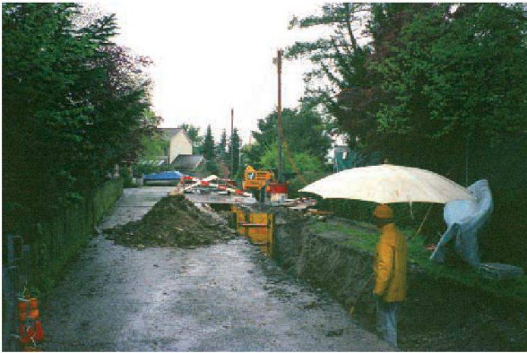
Abb. 7: Augst BL, Schufenholzweg (Grabung 2005.053). Etliche Tage mit Dauerregen prägten die Aushubarbeiten für den Graben. Arbeit an der letzten Etappe im unbefestigten, südlichsten Teil des Schufenholzwegs. Von Süden.
