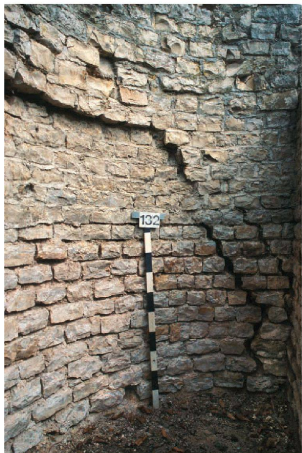
Abb. 38: Augst, Theatersanierung (Grabung 2005.055). Peripherie, Keil 4. Entlastungsbogen MR 140 mit leicht verschobenem, originale Kalksteinmauerwerk und statisch bedingter Rissbildung in der Mauerschale.
