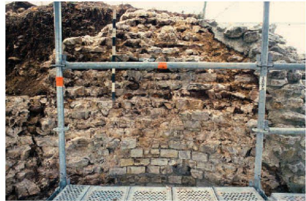
Abb. 40: Augst, Theatersanierung (Grabung 2005.055). Peripherie, Keil 4. Entlastungsbogen MR 138 mit freiliegendem, von Frost und Erosion stark in Mitleidenschaft gezogenem Mauerwerkern.
