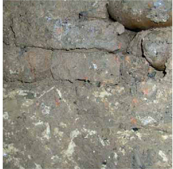
Abb. 23: Kaiseraugst AG, Wacht/Künzli (Grabung 2006.004). Übergang vom Trockenmauerwerk zum in den anstehenden Felsen gehauenen Schacht.
