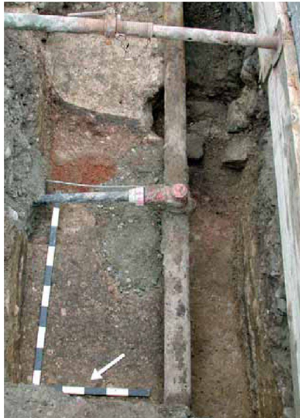
► Abb. 10: Augst BL, Leitungsgraben Merkurstrasse (Grabung 2006.053). Blick in den Leitungsgraben. Im Vordergrund unter dem Nordpfeil der Rest eines Terrazzobodens, im Hintergrund unter der Querstrebe eine Mauer, die von der alten Wasserleitung durchschlagen wird.
