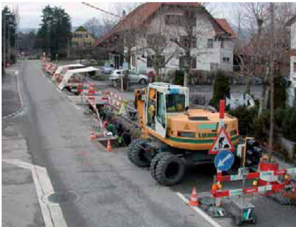
Abb. 9: Augst BL, Leitungsgraben Merkurstrasse (Grabung 2006.053). Blick über die erste Etappe des Leitungsgrabens im Bereich der Giebenacherstrasse. Von Südosten.
