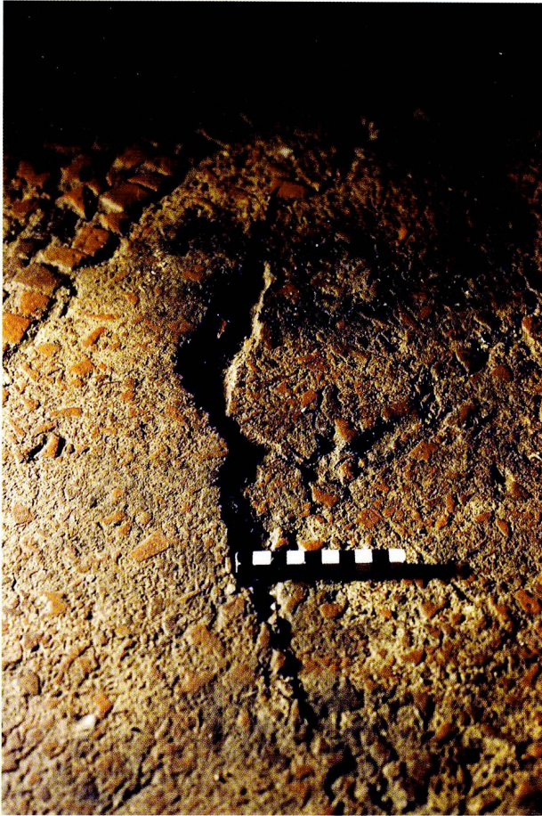
Abb. 25: Augusta Raurica, Region 2A westlich des Theaters. Durch Absacken des Untergrundes entstandener Riss. Aufnahme im Streiflicht.
