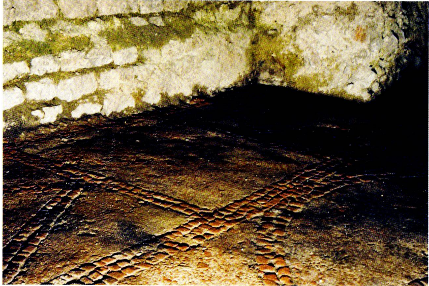
Abb. 8: Augusta Raurica, Region 2A westlich des Theaters. Unebene Oberfläche im Streiflicht mit Blickrichtung nach Südosten.
