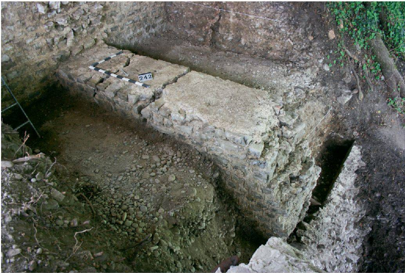
◀ Abb. 16: Augst BL, Stützpfiler Schönbühl (Grabung 2009.052). Blick auf die Abbruchkronen von Mauer 4 von Nordosten mit den beiden Querrissen. Rechts am Bildrand verläuft die Stützmauer MR 5, die nach Norden verkippt ist und sich von Mauer 4 gelöst hat.
