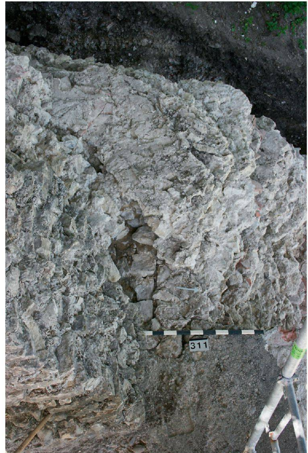
Abb. 22: Augst BL, Stützpfiler Schönbühl (Grabung 2009.052). Blick auf die nur knapp freigelegte nördliche Mauerschale des älteren Stützpfilers MR 6 (links oberhalb des Massstabs).
