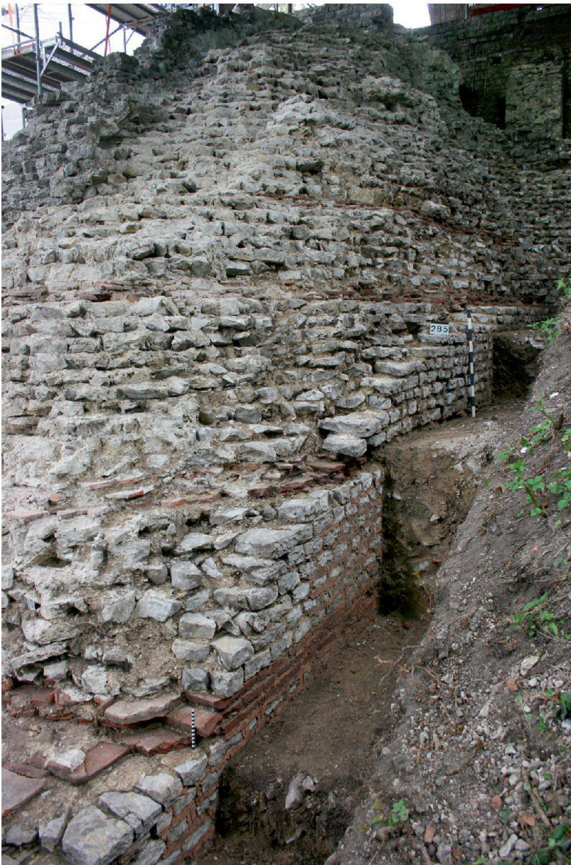
◀ Abb. 19: Augst BL, Stützpfiler Schönbühl (Grabung 2009.052). Ansicht der westlichen Mauerschale mit den Ziegeldurchschüssen und dem Kernmauerwerk. Von Nordwesten.
