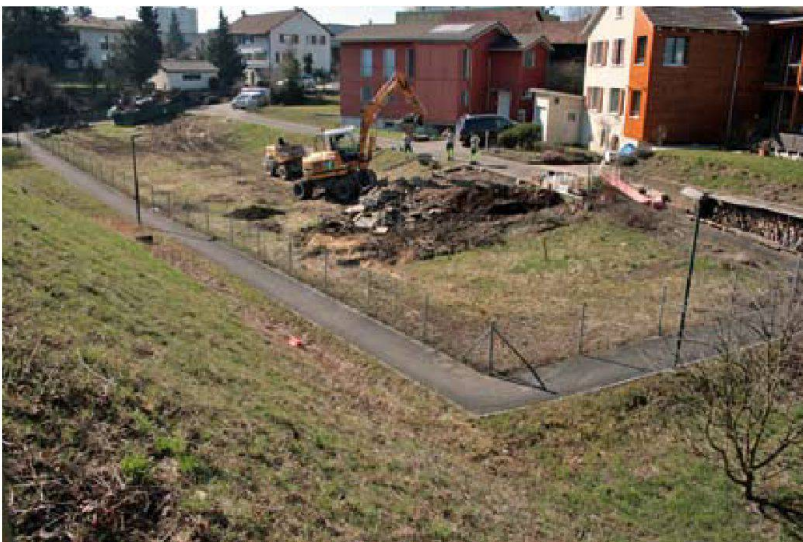
◀ Abb. 8: Augst BL, Hausmatt (Grabung 2010.053). Übersicht über die Hausmatt vor Beginn der Ausgrabungsarbeiten. Der Bagger und die anderen Baugeräte sind für die Räumung der Parzelle im Einsatz. Von links nach rechts vorne, danach rechtwinklig abknickend der Schlössliweg, entlang der Häuser im Hintergrund die private Erschliessungsstrasse, die bis 1998 der Schlössliweg war. Von Südosten.
