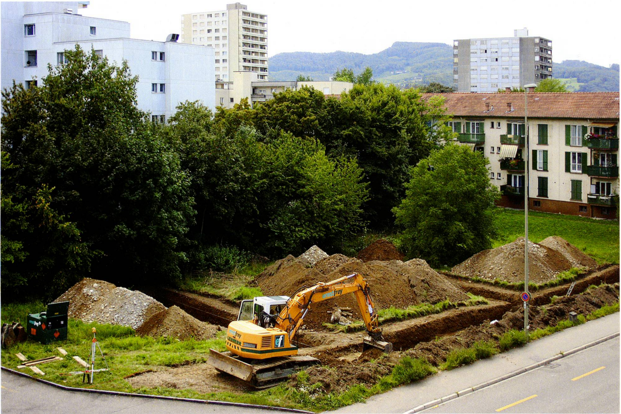
Abb. 24: Pratteln BL, Rheinstrasse (Grabung 2011.057). Übersichtsbild kurz vor dem Abschluss der Baggerarbeiten. Im Hintergrund die Überbauung Pratteln-Längi, vorne rechts die Rheinstrasse. Von Nordosten.
