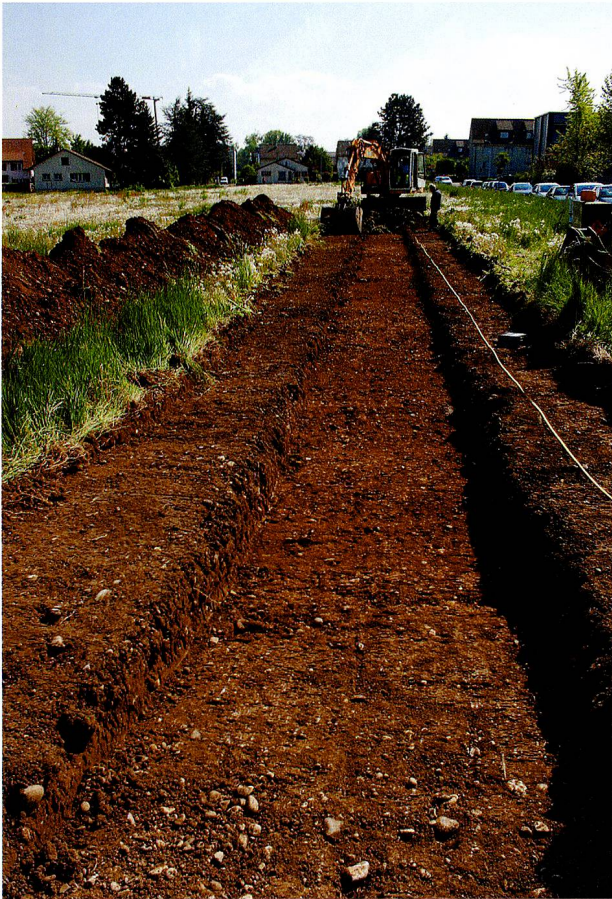
Abb. 7: Augst BL, Sondierung Gallezen (Grabung 2011.053). Der westliche Teil des Sondiergrabens ist ausgehoben. Von Westen.
